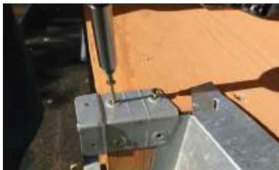
Fig. 3: Tutte le parti metalliche vanno fissate e le viti mancanti rimpiazzate. Foto Paolo Fontana.
